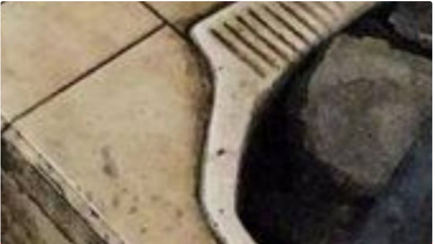
Toilet pasar rusak seperti ini, penjual dan pembeli mengeluh
