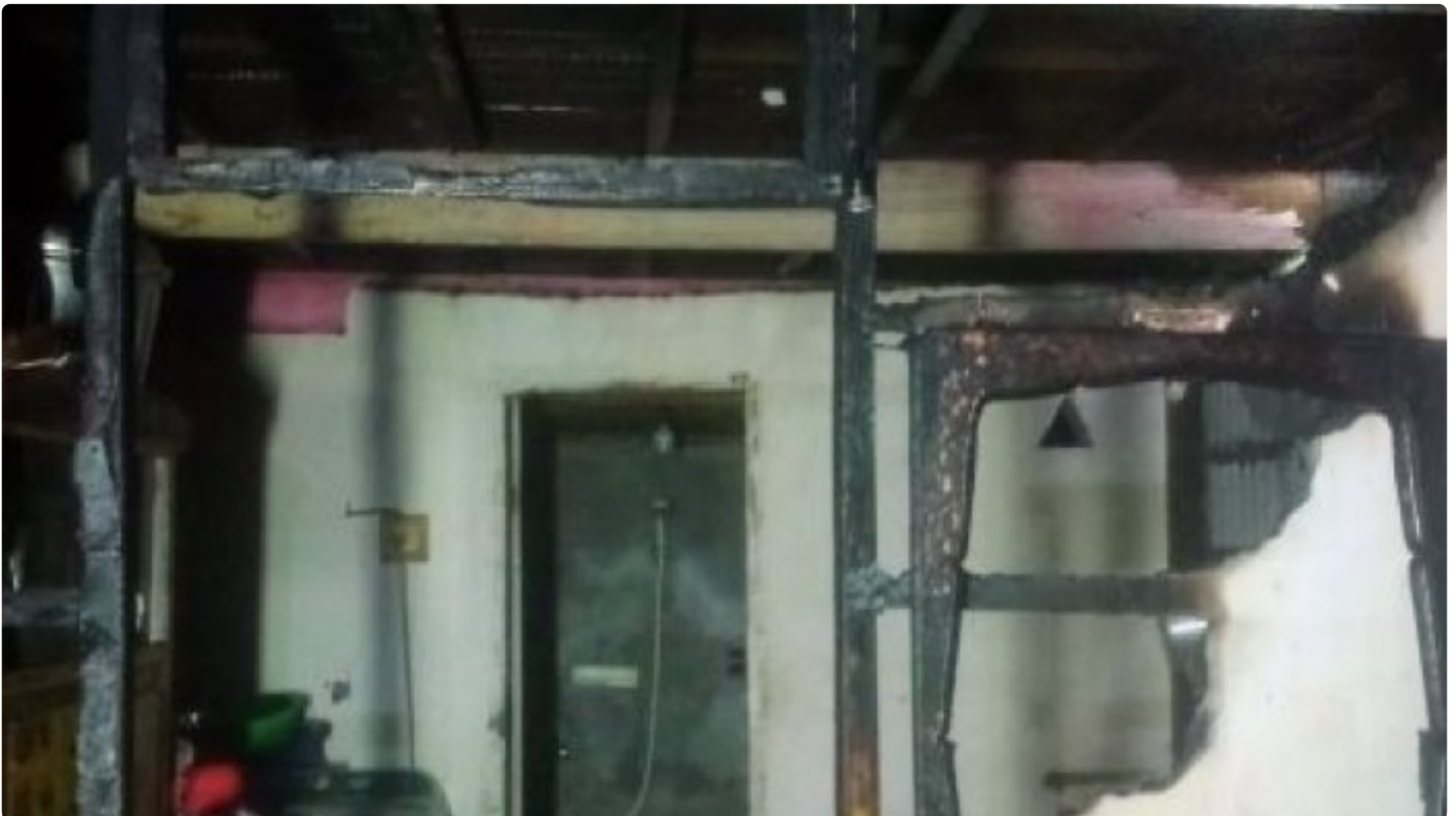
Bagian dapur rumah milik warga Bungi, desa Lalabata, kecamatan Tanete Rilau atas nama Rusli terbakar akibat tabung gas meledak
