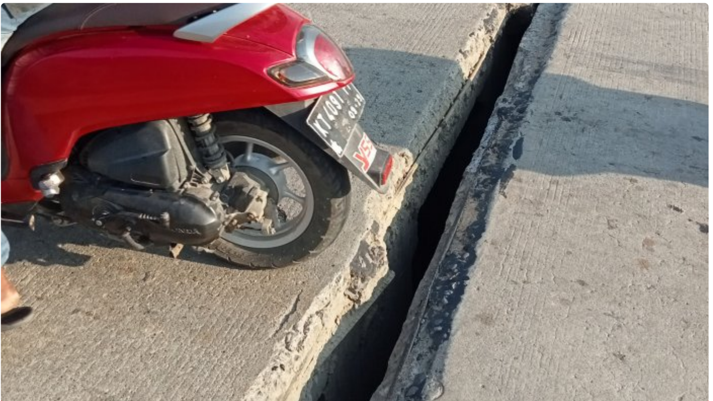
Nampak lubang selebar 20 cm di sambungan jalan fly over Pekkae
