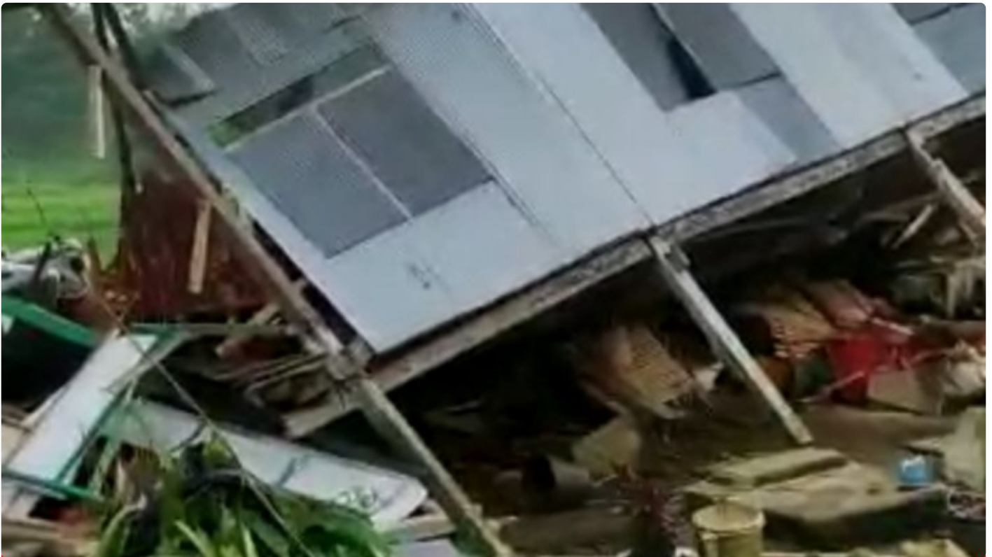
17 rumah rusak parah akibat angin puting beliung di Desa Pancana, Kecamatan Tanete Rilau, kabupaten Barru
