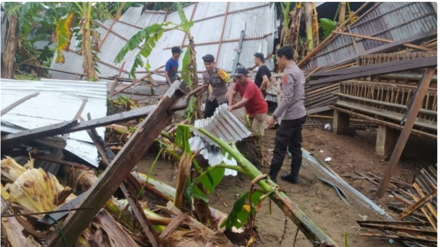
Bangunan rumah peternakan ayam milik warga Polejiwa roboh rata dengan tanah usai diterjang angin puting beliung
